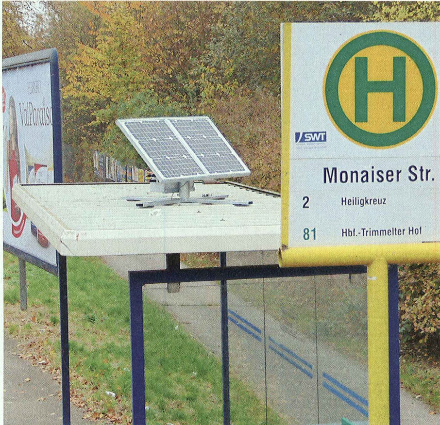
Haltestelle mit Fotovoltaik-Modul: Solare Beleuchtung an Busstops erhöht den Komfort für Nutzer des Nahverkehrs, ohne dass die hohen Kosten eines Stromnetzanschlusses fällig werden.
